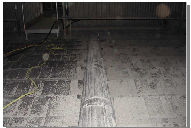
Rostabdeckungen nach ca. 6.000 Std. Einsatz – keinerlei Abnutzung erkennbar
